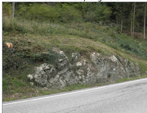
Affioramenti di calcari marnosi. Si notano le numerose soluzioni di continuità. Circa 100 m a Nord, lungo la S.P.
